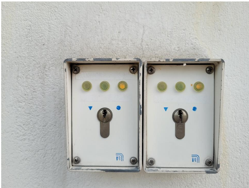
Alarmanlage scharf, Türen nicht öffnen
