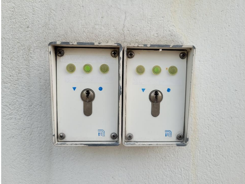
Alarmanlage unscharf, Türen dürfen geöffnet werden.
